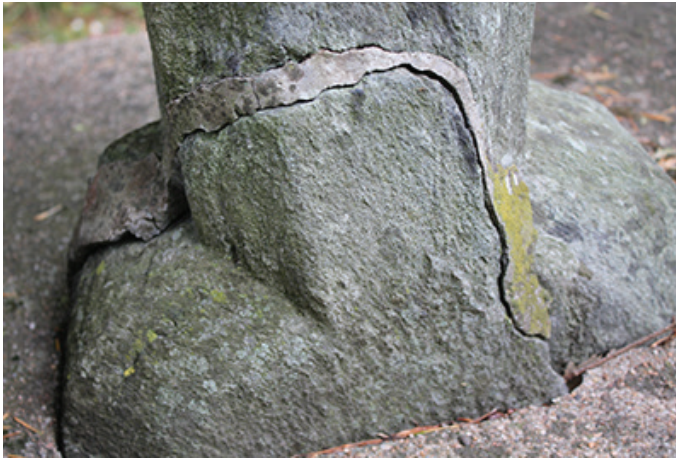
Socle fracturé, cimenté
